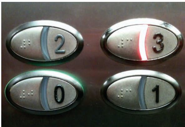
Botones en los tableros de control que pueden distinguirse por el tacto.
